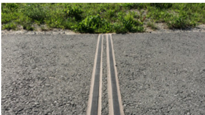
Die im Boden eingebauten Sensoren sind für Velofahrende nur schwer zu erkennen bzw. fallen nicht auf
